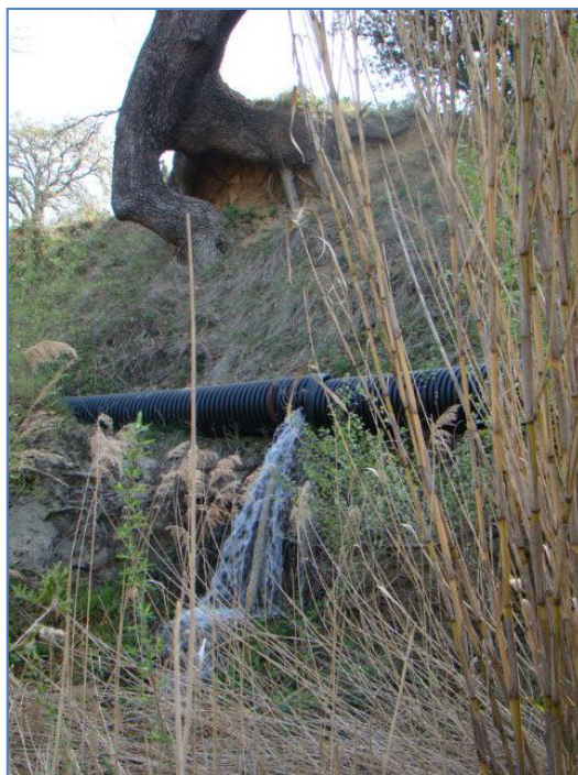
Conduite d'eau à Cairanne
