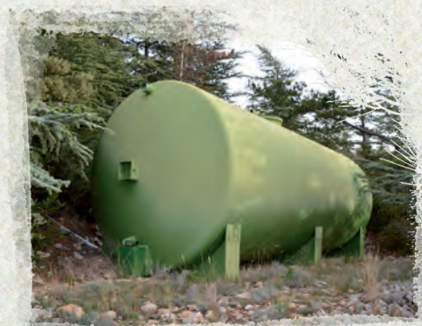
Masquée par des arbres, cette citerne met 60 000 l d'eau à disposition du troupeau. Les autres citernes installées sont enterrées pour limiter l'impact paysager.
